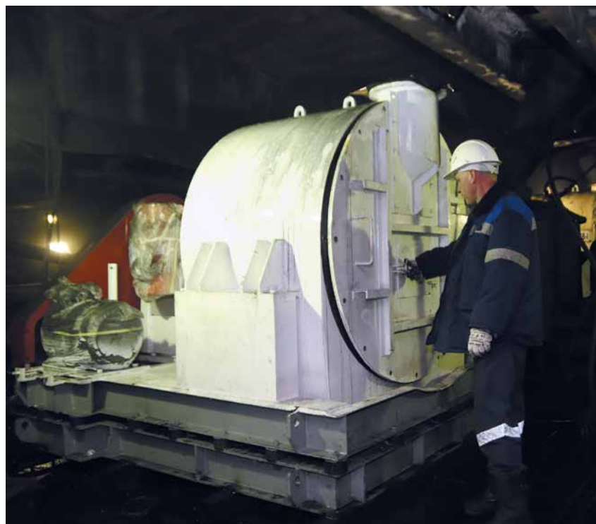
На ЦОФ «Сибирь» установлены три новые обезвоживающие центрифуги
